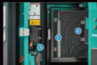
左侧舱室 散热器和冷却系统，触手可及。 ④ 总电源开关 ⑤ 带有防虫网的散热器 ⑥ 柴油冷却器
